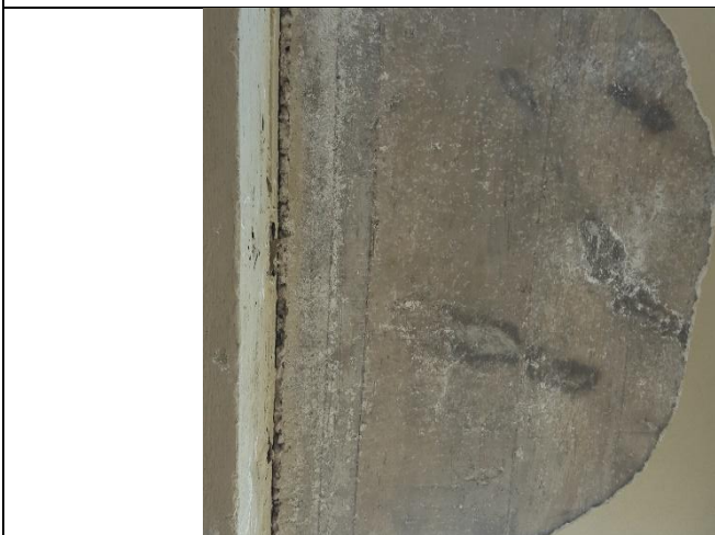
Αποκόλληση επιχρισμάτων στον ανελκυστήρα
