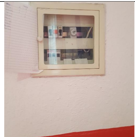
Ηλεκτρολογικό δίκτυο γυμναστηρίου
