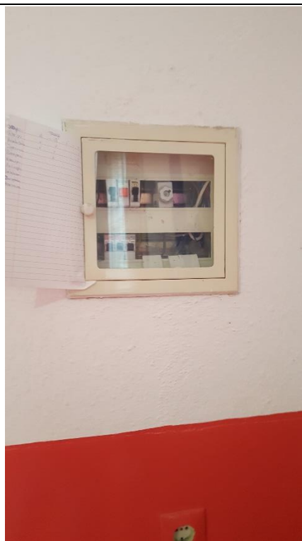
Ηλεκτρολογικό δίκτυο γυμναστηρίου
