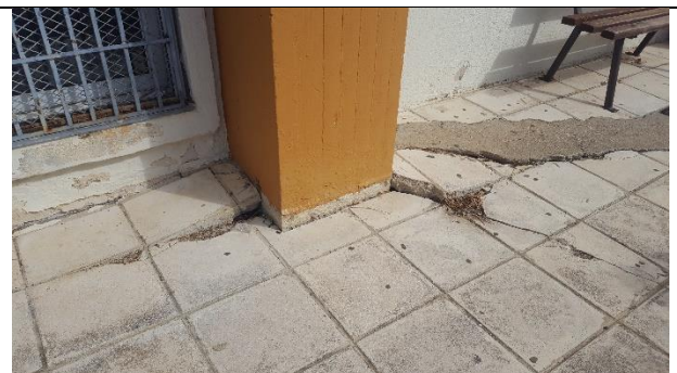
Αστοχία δικτύου απορροής ομβρίων
