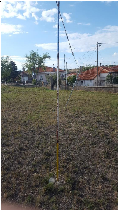
Εναέριο δίκτυο ρεύματος στην αυλή
